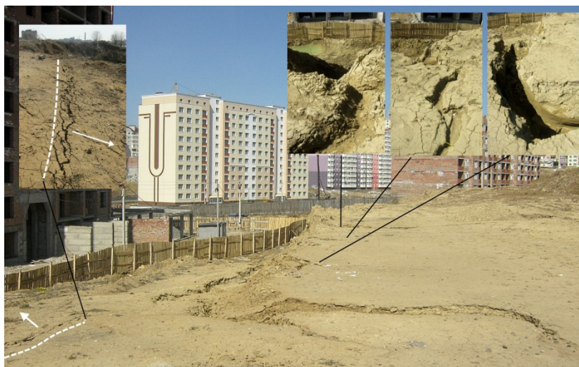
Рис. 2. Ерозійні промивини і тріщини заколювання зсуву (біла штрихова лінія) на штучному уступі над ділянкою будівництва по вул. Панаса Мирного.
